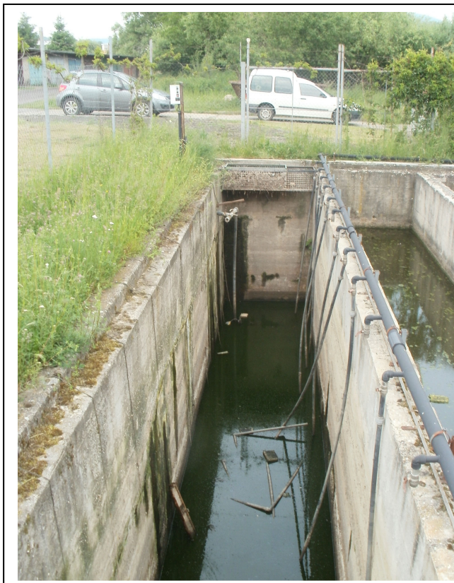
Nádrž na zväžané vody
