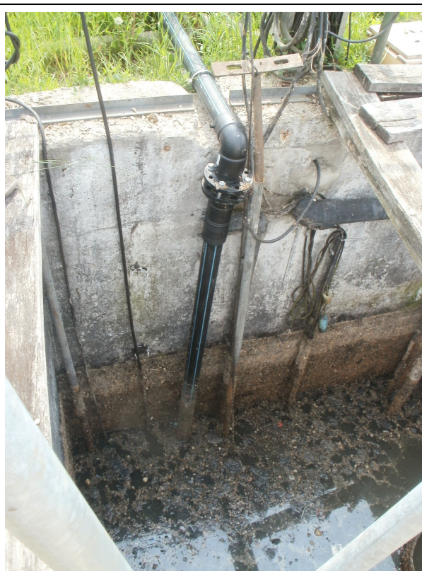
Čerpacia stanica – výtlak čerpadla
